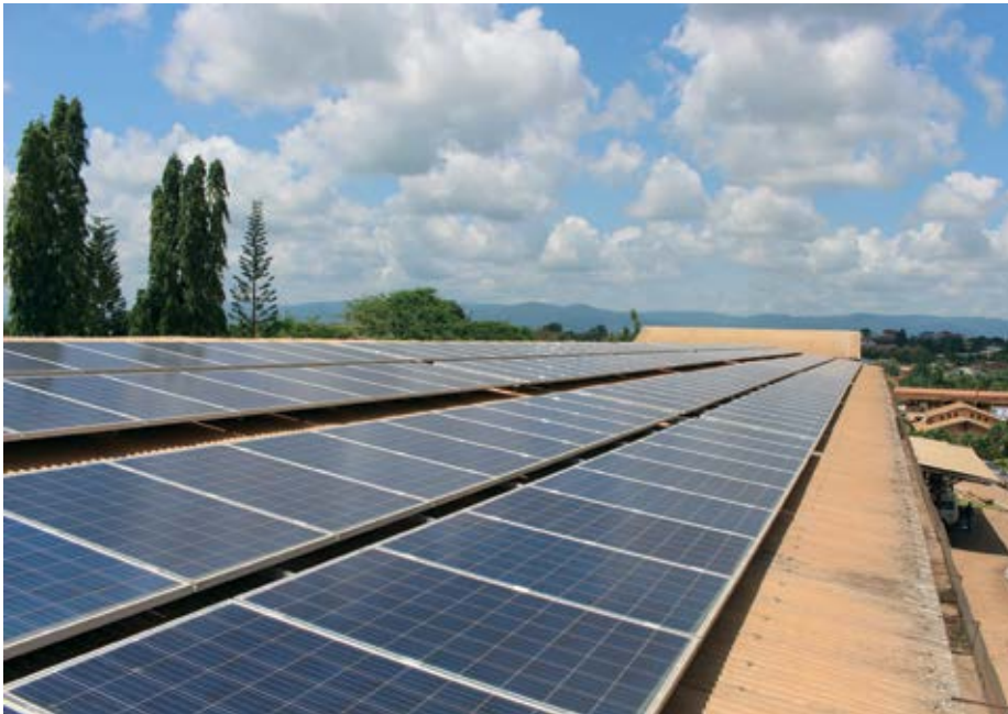
Solarmodule auf dem St. Dominic Catholic Hospital in Akwatia im Süden Ghanas.
